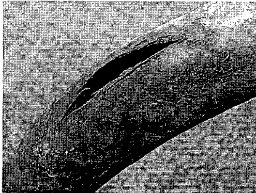
شکل ۴۱.۴. شکست لبه کلفت در محل خم لوله سوپرهیتر
