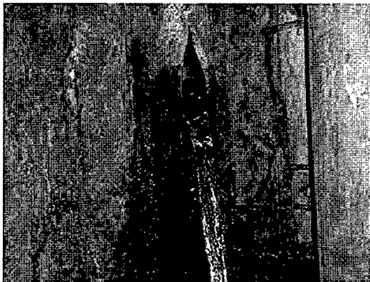
شکل ۳۱.۵. گسیختگی لوله و خروج آب از محل پارگی که موجب سردشدن سریع لوله و تشکیل ساختار بینیتی شده است.
